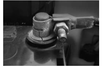
亀裂が入ったターミナル
