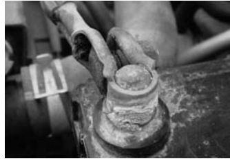
腐食したターミナル
